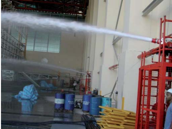
Figura 12: Protección suplementaria de un Hangar del Grupo 1
