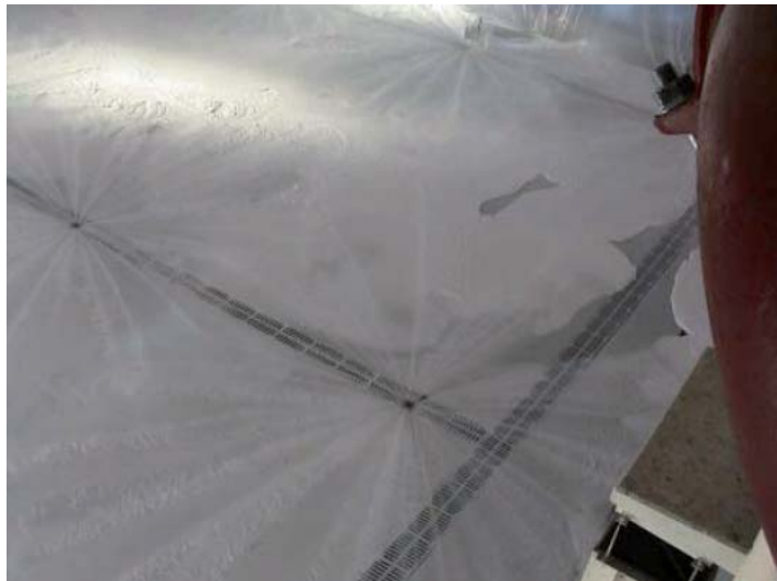
Figura 10: Descarga de un Sistema de Espuma de Baja-Presión situado en el suelo.
